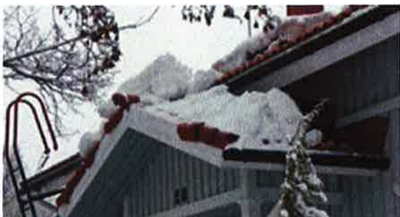
Lumi rikkoi pudotessaan kuistin katon reunatiilit ja irrotti seinätikkaat.
